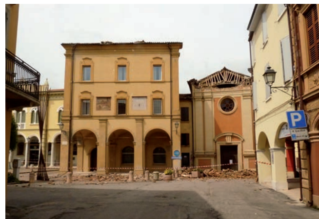
Danni prodotti dal terremoto del 20 maggio 2012 a San Felice sul Panaro (MO).
