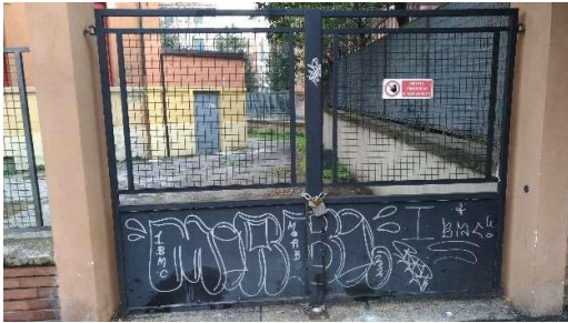
Cancello su via Murri da verniciare
